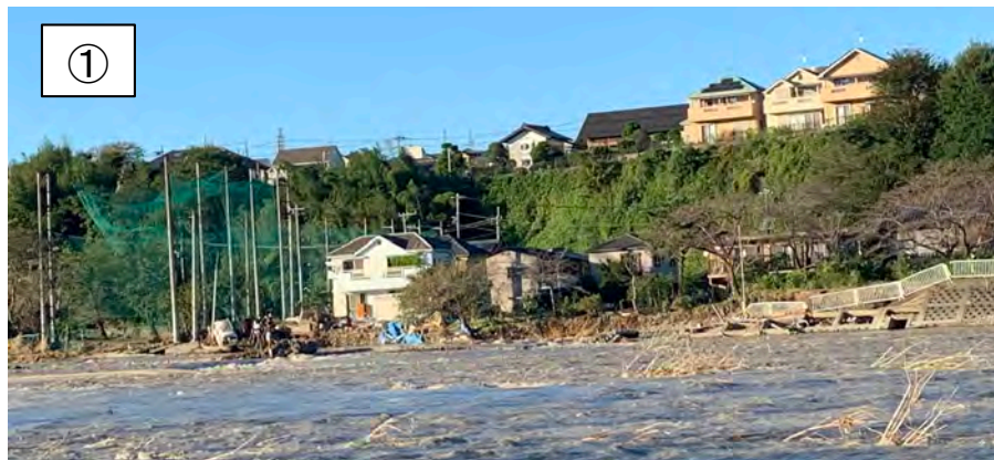
護岸の損壊、家屋への浸水（13日撮影）
